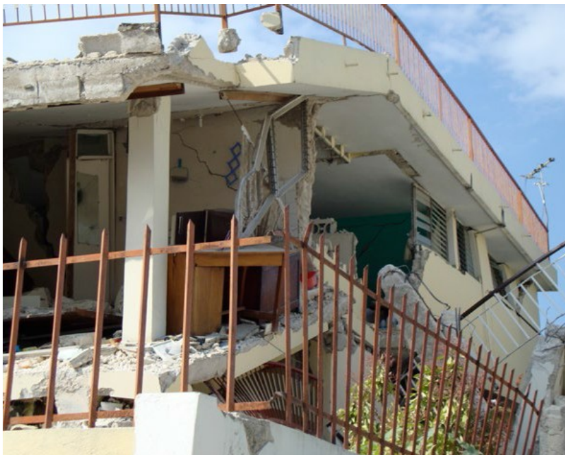
2010 年海地大地震被毀損的建築物。
